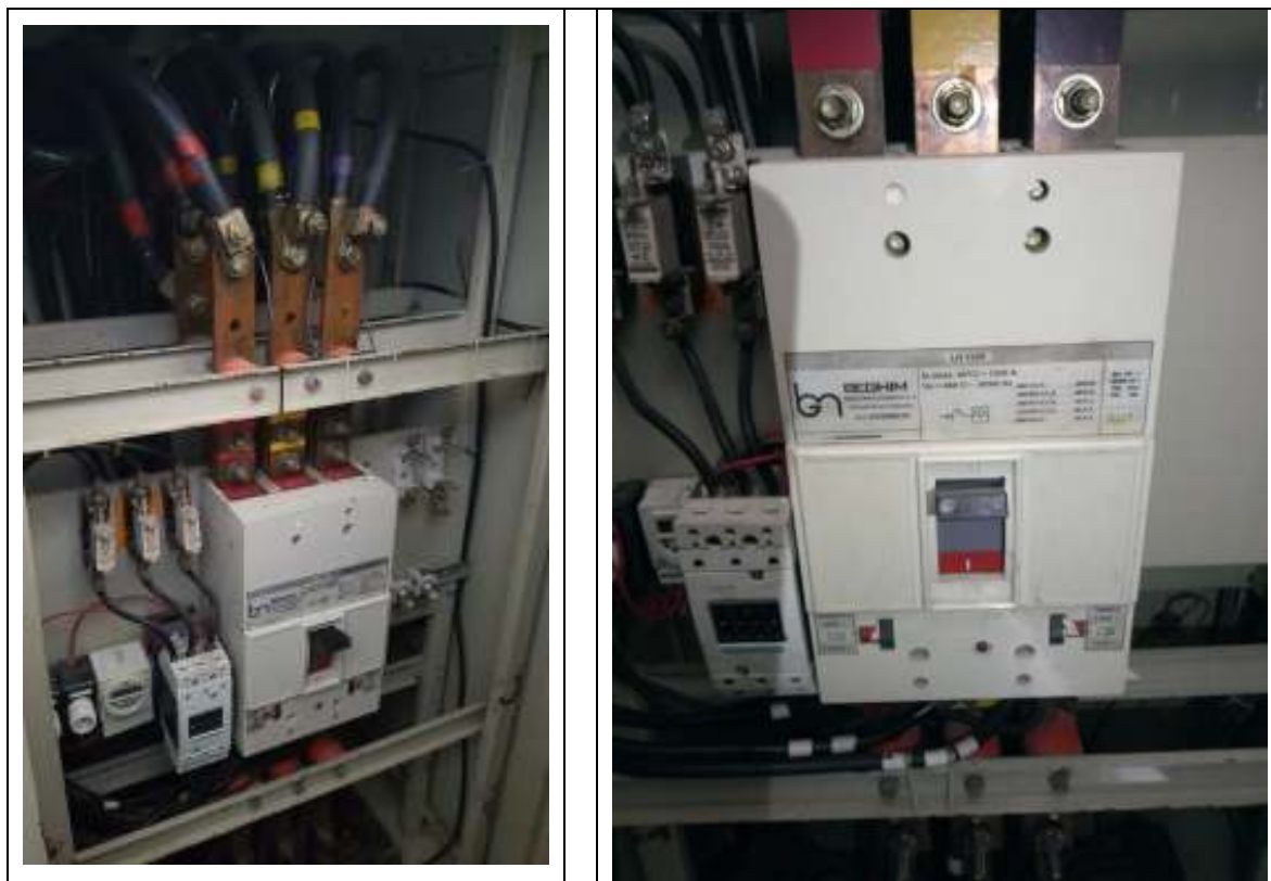
Figura 3 – Disjuntores dos quadros do Trafo 05 e 06 da Subestação
