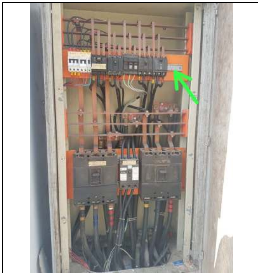
Figura 1 – Quadro Geral de Distribuição Normal do Pavilhão Ítalo Sherlock
