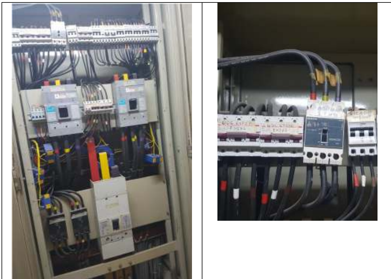
Figura 1 – Quadro Geral de Emergência localizado na Casa de Maquinas do Pavilhão Zilton Andrade/ Disjuntor Tripolar de 100A Siemens existente
