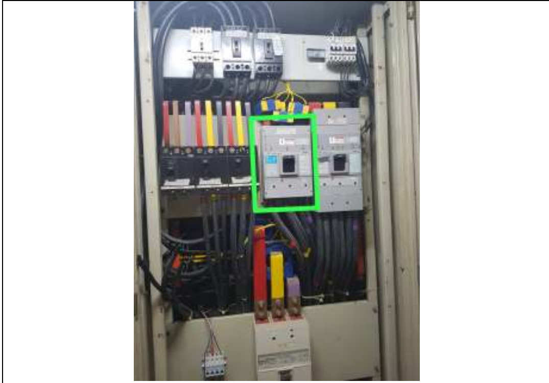
Figura 1 – Quadro Geral de Ar Cond. localizado na Casa de Maquinas do Pavilhão Zilton Andrade
