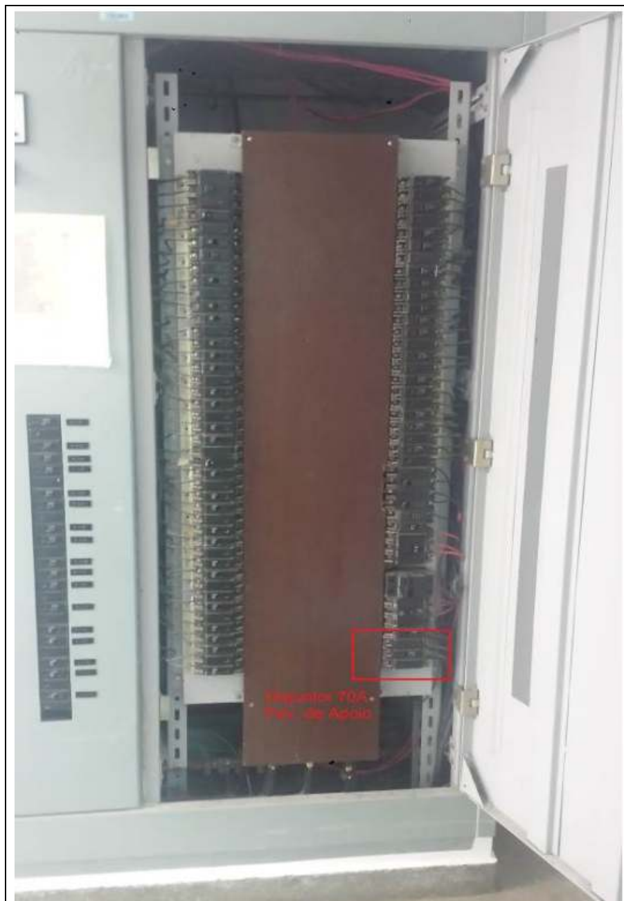
Figura 1 – Quadro Elétrico QDLF E-2 do Pav. Lasp
